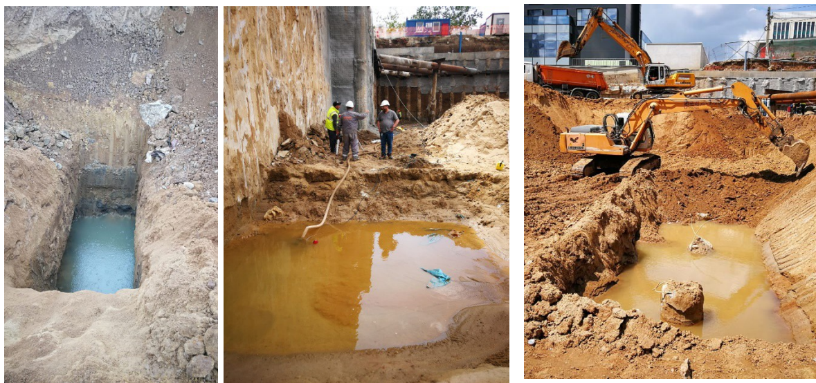
Figura 5 – Prezența apei subterane în interiorul incintei la cota -9,50 m
