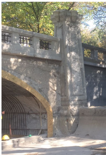
Figura 4. Detaliu fisuri și crăpături constatate pe timpane și stâlpii monumentali, în urma decopertărilor tencuielilor
