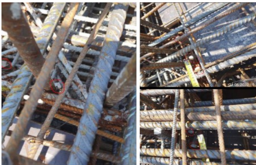
Figura 7 – Exemplificare neconformitate noduri
