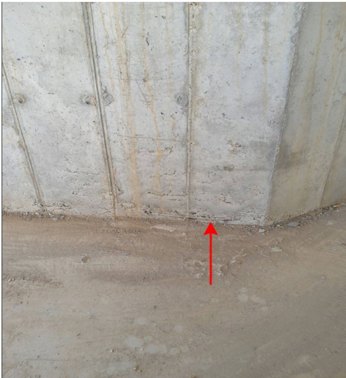
Figura 4 – segregare a betonului la partea inferioară, cu armătura vizibilă
