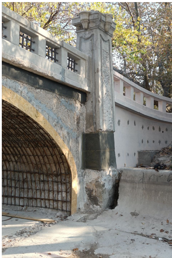
Figura 5. Detaliu suprafețe tratate după aplicarea mortarelor de reparații; Detaliu crăpătura între stâlpi și zidurile de sprijin de pe maluri
